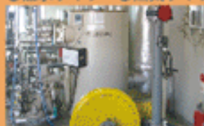
⑧温水ボイラ ⑨蒸気ボイラ
