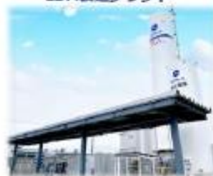
LBM製造プラント
