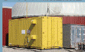
⑦バイオガス精製圧縮装置
