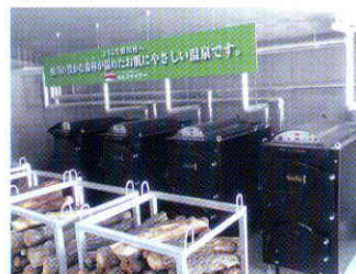
▲全国初の試み 「脱農場前通路から一望できる薪ボイラー室」
